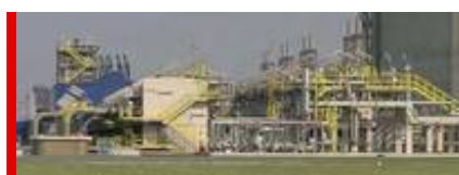
Flüssiggas-Anlage in Rotterdam
